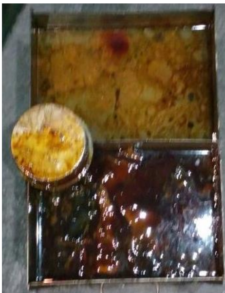
Figura 39 - Reservatório de óleo da bomba de refrigeração (Antes).
