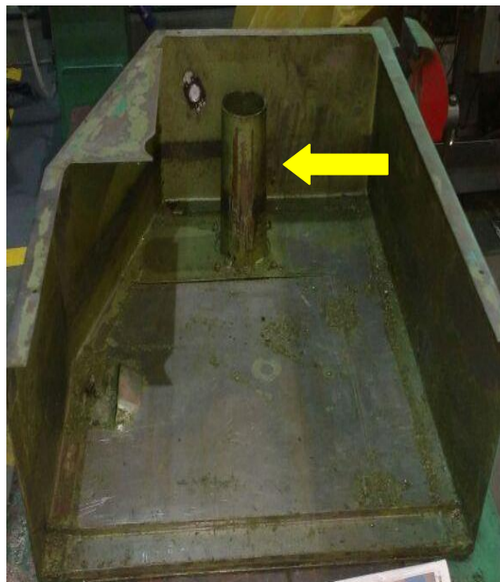
Figura 42 - Caixa de proteção das correias e engrenagens – (Antes).
