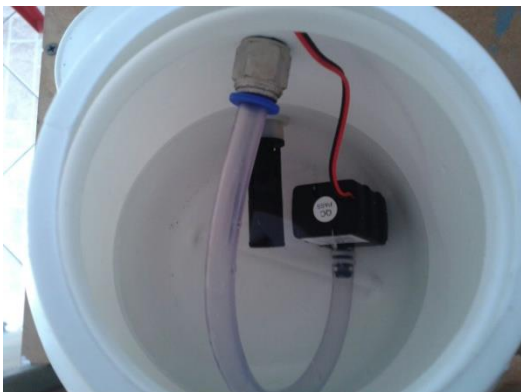
Apêndice 7 – Reservatório de água, com bomba e sensor de nível
