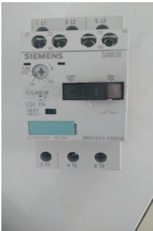
(figura 12) disjuntor motor
